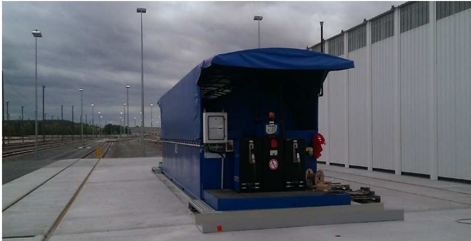
Figure 76 : Station de distribution de carburant de la base travaux de Nouâtre-Maillé
